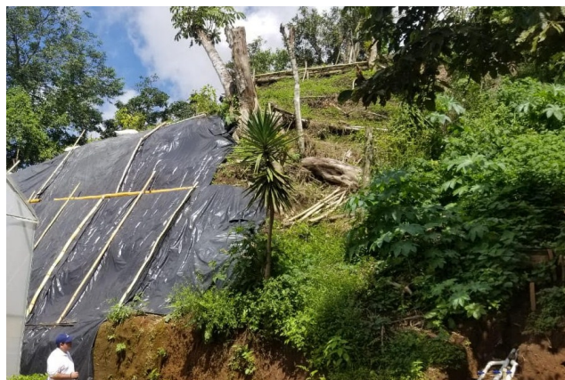
Fotografía tomada durante diligencia de inspección.
